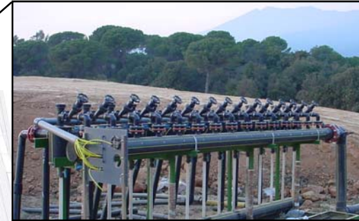
ESTACIÓN DE REGULACIÓN
